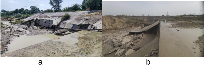
Şəkil 5. Vəlvələçayda sağ sahil beton örtüyünün (a) və suaşırın bəndin (b) seldən sonra dağılımı vəziyyəti
